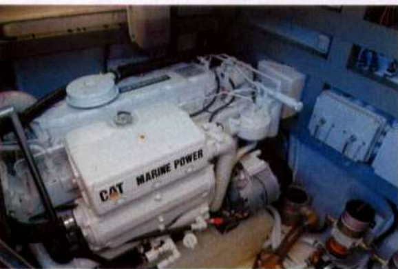
La sala motori ospita due entrobordo Caterpillar C7 da 420 cavalli.
